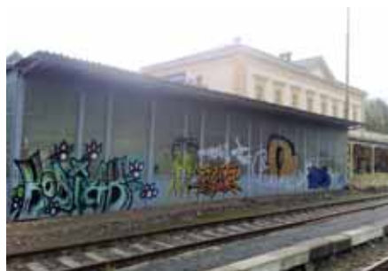
Úplně zničený podchod u nádraží
